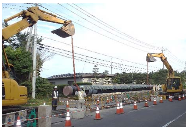
太いガス管 (写真提供：東京ガス株式会社)
